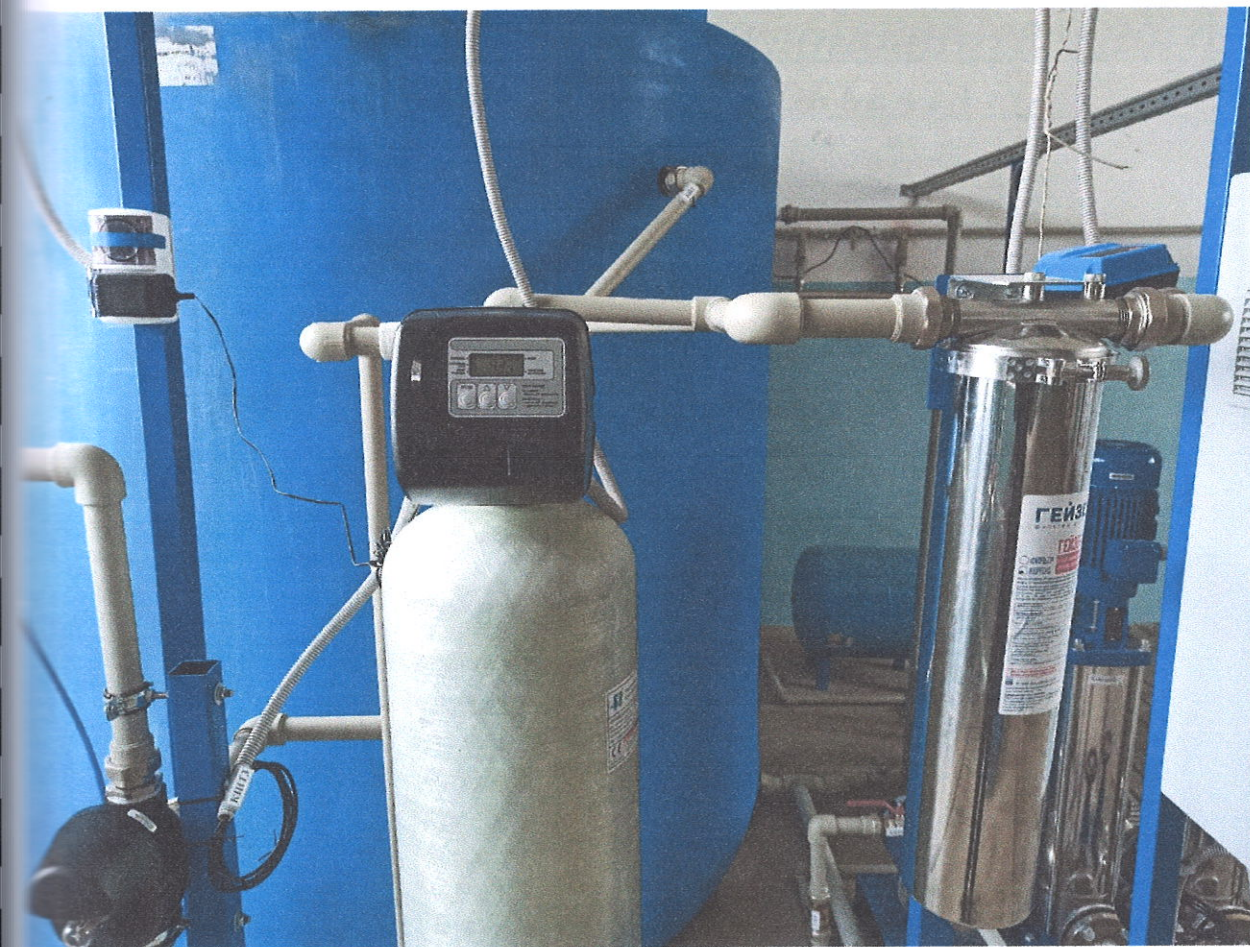
Фильтр обезжелезивания и мешочный фильтр тонкой очистки воды
