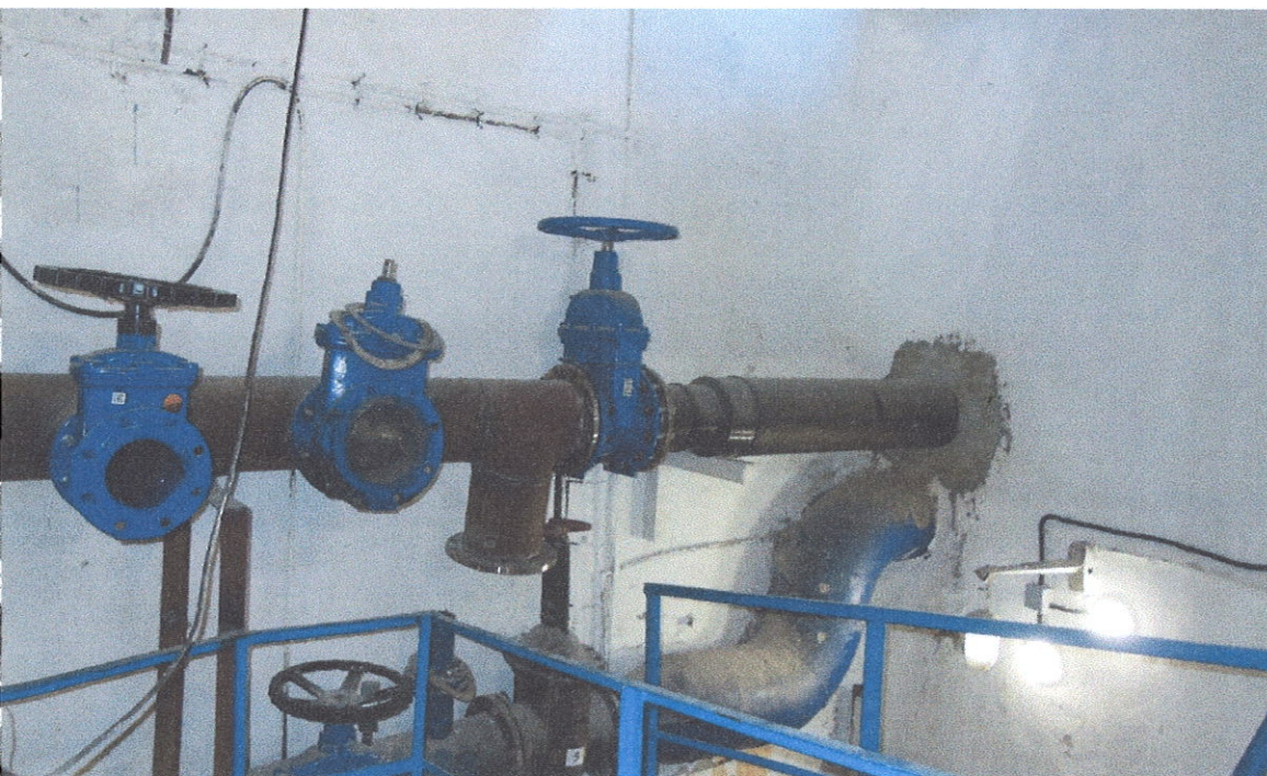
Конструкция насосного оборудования, присоединенного к системе управления и электропитания КНС №2
