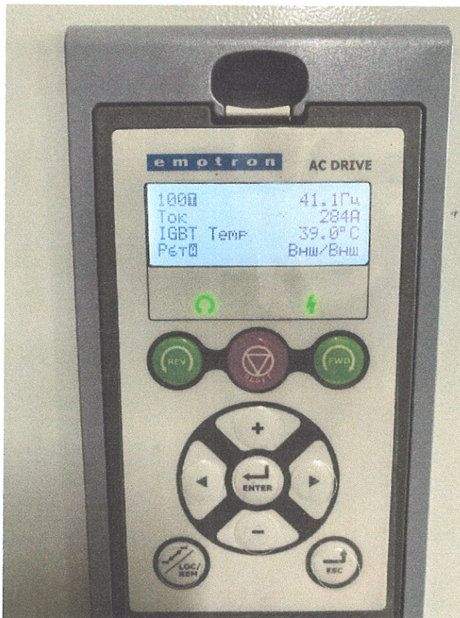
Шкафы управления насосным оборудованием
