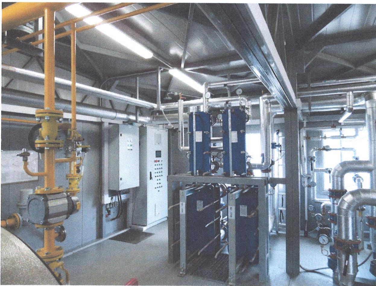
Система газоснабжения, пр-кт Дзержинского, 43
