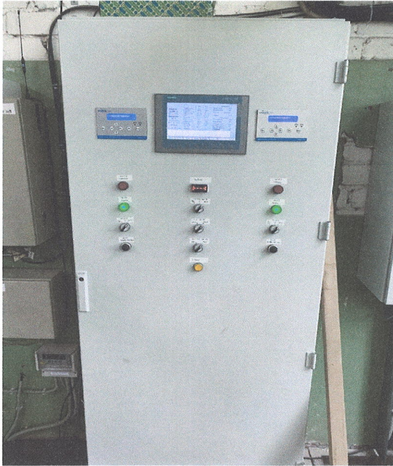
Шкаф управления насосным оборудованием
