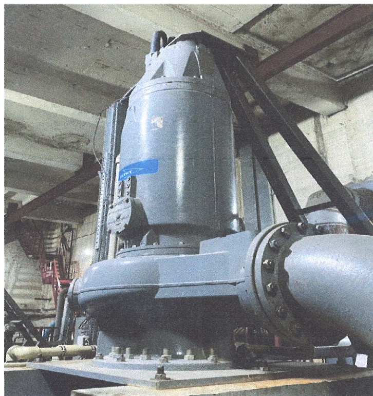
Модернизированное насосное оборудование, присоединенное к системе электропитания КНС 101/1
