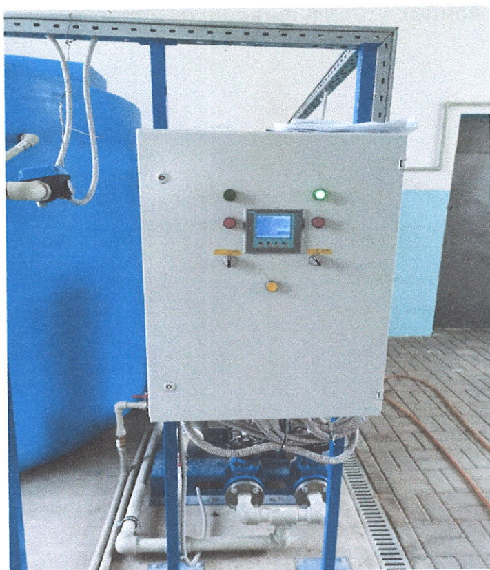
Шкаф управления АСУ технологическим процессом водоснабжения ПХВ РОС
