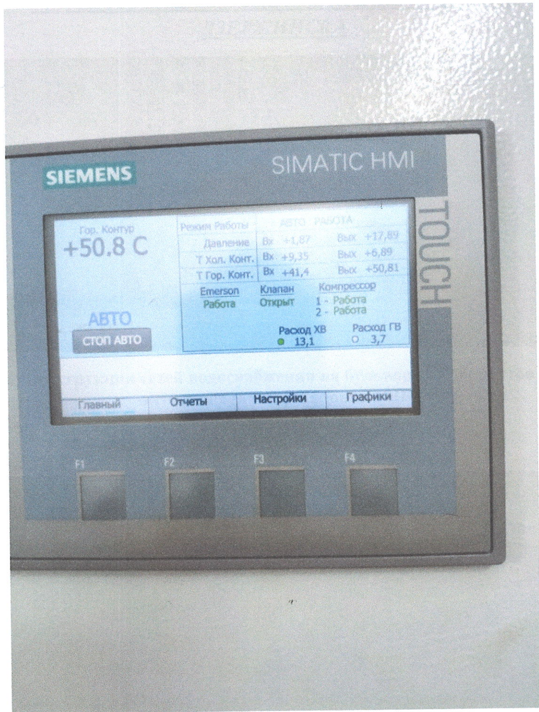
Монитор шкафа управления
