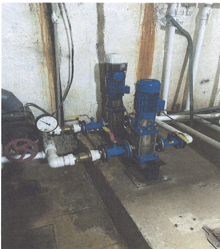
Модернизированное насосное оборудование, присоединенное к системе электропитания КНС 101/1
