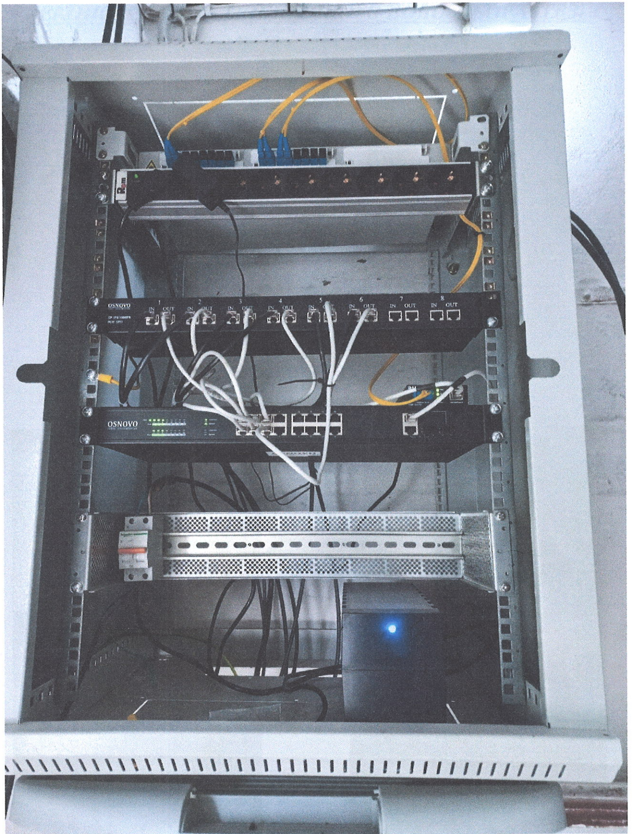
Коммуникационный шкаф, входящий в систему охранной сигнализации с ИБЭС на насосной станции 3 подъема
